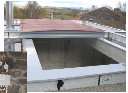
Silo à bois déchiqueté de la chaufferie
